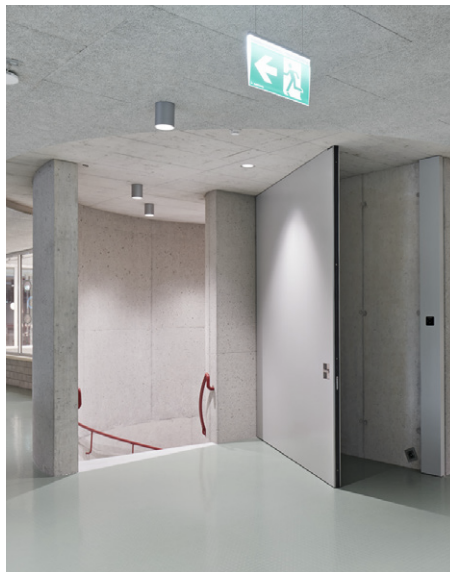
Fermeture activée en cas d'incendie.
